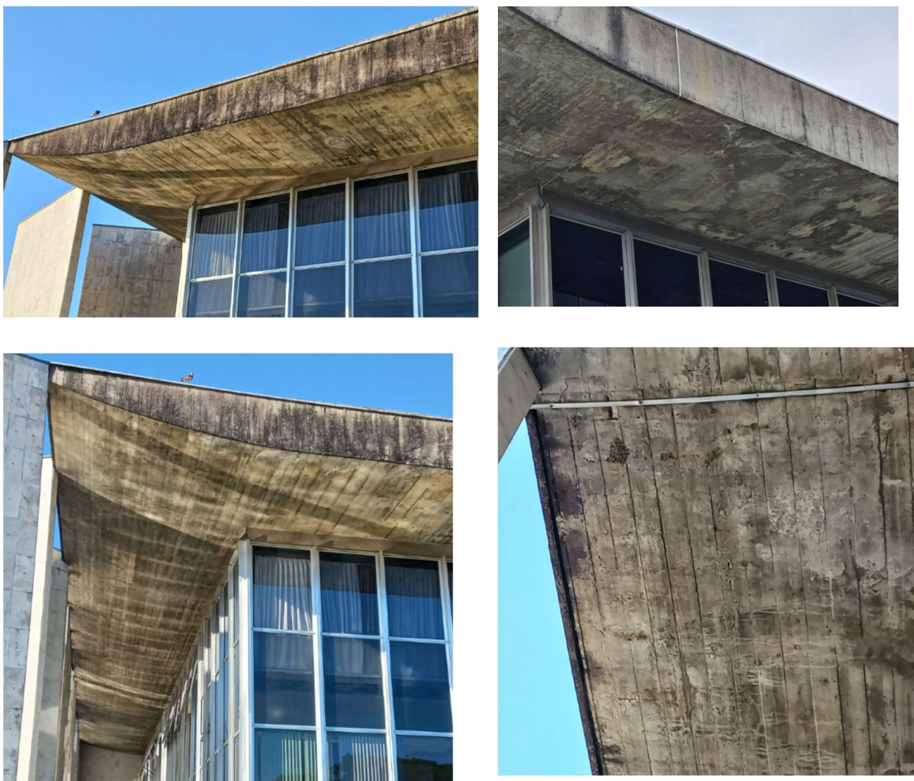
Figura 17 - Manchas e eflorescências na marquise
