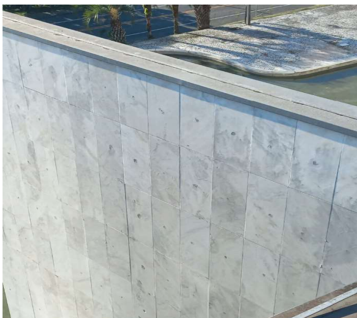
Figura 6 - Falta de rejunte nos brises
