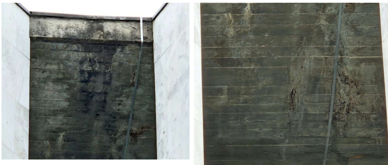
Figura 18 - Infiltrações de água na marquise
