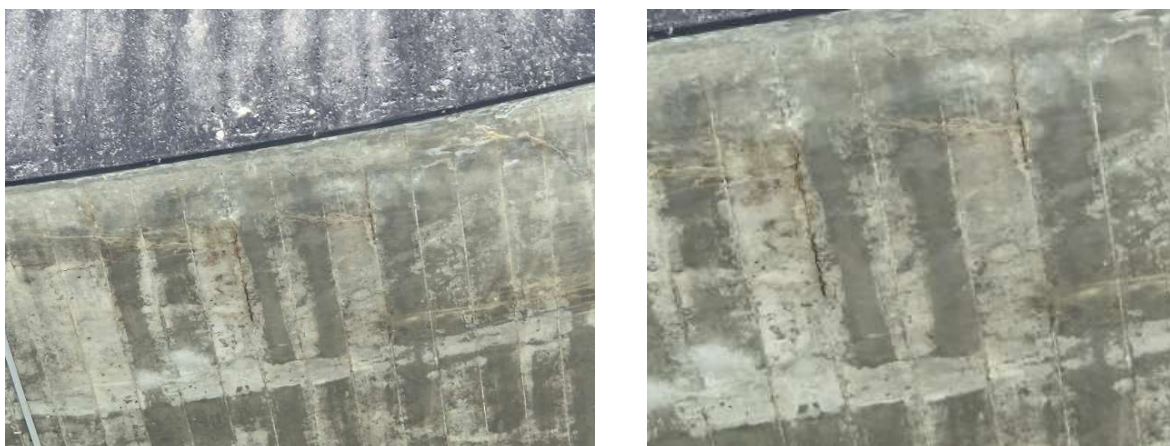
Figura 15 - corrosão das armaduras a marquise
