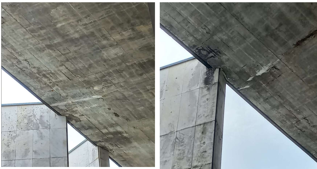
Figura 19- Deterioração da superfície na marquise
