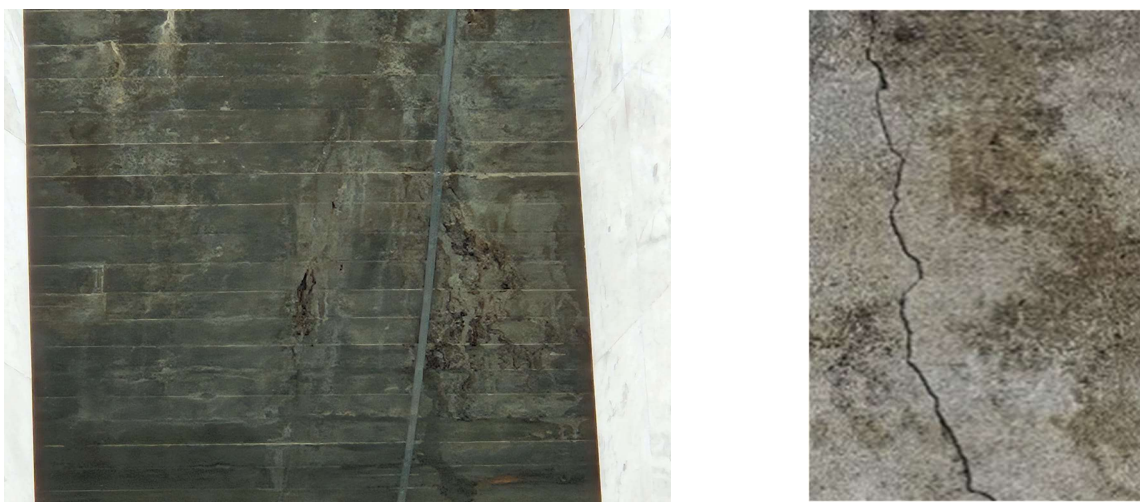
Figura 14 - Fissuras e trincas na marquise
